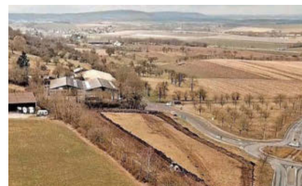
Zwischen Verrenberger Rind und Reiterhof Benner liegt die ehemalige Pferdekoppel, auf der bereits die Erdbewegungen für den künftigen Wohnmobilhafen begonnen haben.
